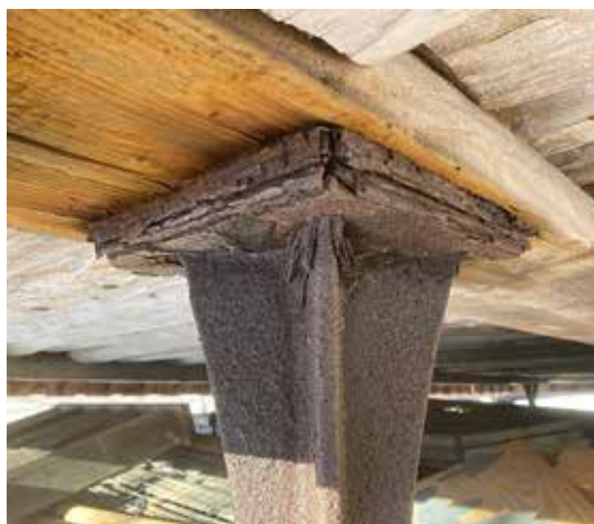
Alvorlig rustskade. Foto: Kåre Holtung.
