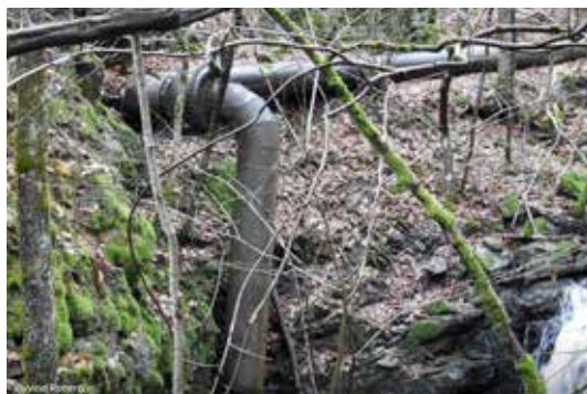
Vannrør ved Dalsfossen.
